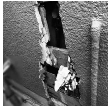
剥離する外壁
