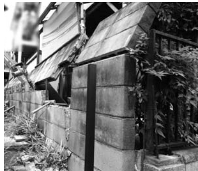
至るところで見られるブロック塀の被害
