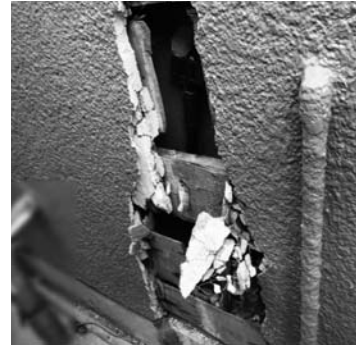
剥離する外壁
