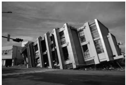
鉄筋コンクリート造建物倒壊（輪島）
