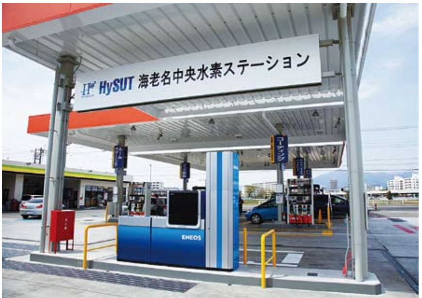
水素充填機（手前）とガソリン計量機（奥）の設置状況
