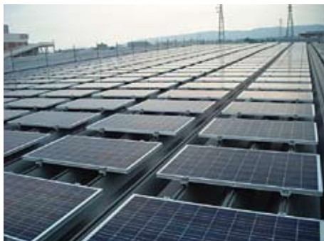
太陽光発電システム
