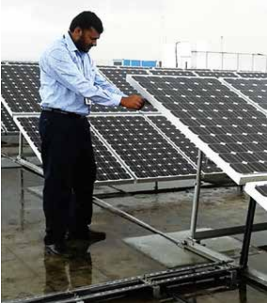
増加するソーラー発電のパネル
